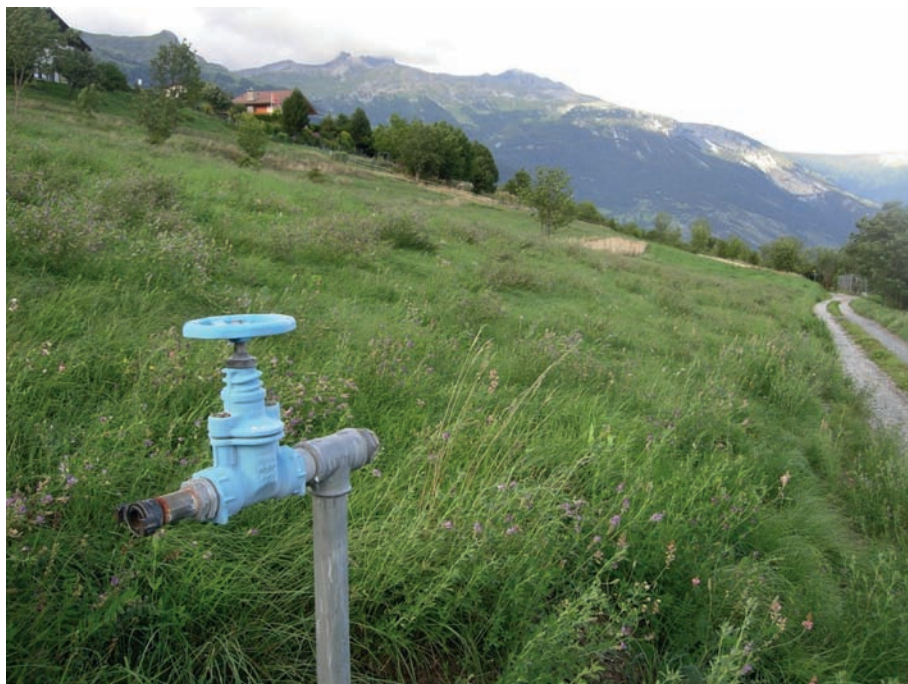
Vanne du réseau d'irrigation sur les prairies de Montana-Village, en Valais (Martin Calianno).
