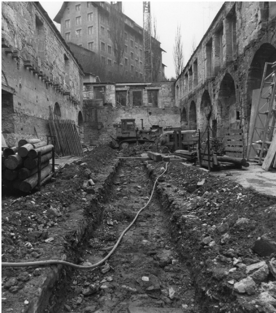
Fig. 3 : Les anciens abattoirs en ruine : le chantier de la reconstruction démarrera à la fin de l'été 1979. © MAHF.
