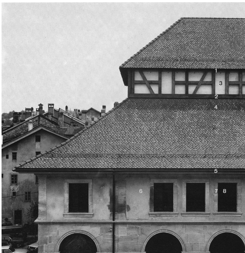
Fig. 5: Description des différentes parties : 1 – Avant-toit supérieur 2 et 3 – Le lanterneau à colombages 4 – Couverture en tuiles 5 – Avant-toit inférieur 6 – Mur en crépis 7 et 8 – Fenêtre avec encadrement en molasse © MAHF.
