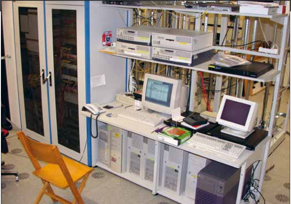
Serverraum vor der Erneuerung im Jahr 2004.
