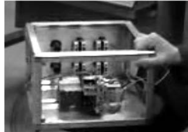
Figure 1: La commande électrique et le câblage construits par ROD avant que MON ne lui demande de recommencer.
