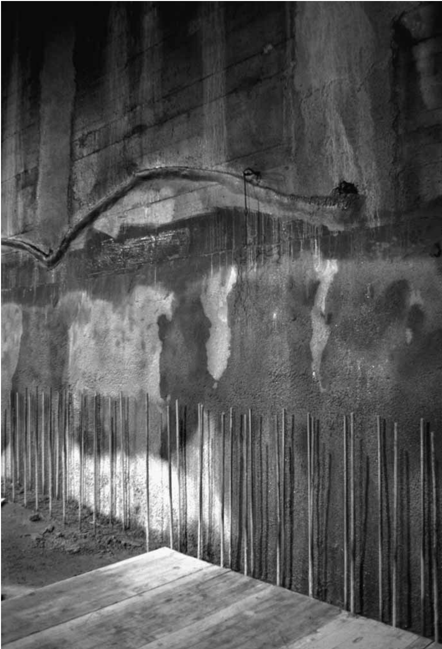
Abb. 21: Wassereintritt in der Maschinenkaverne (AKS, Nachlass Ribaux, 322.6).
