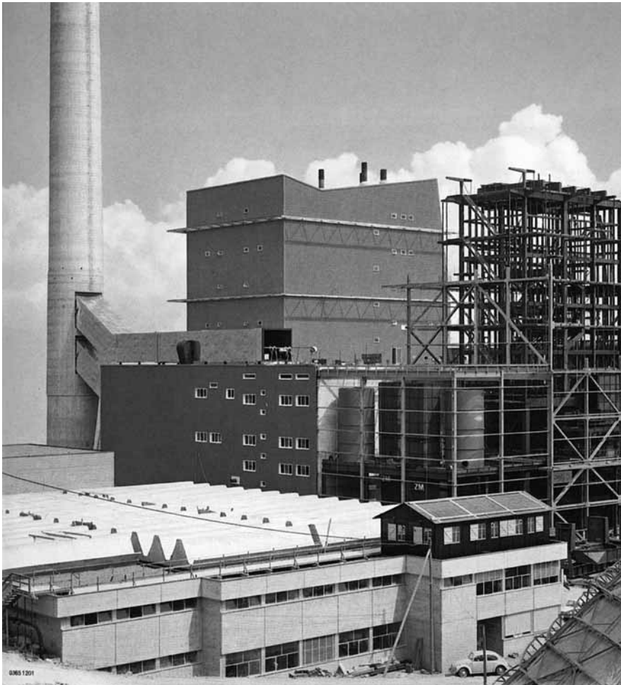
Abb. 19: Thermisches Kraftwerk von Vouvry (GB Sulzer 1965, S. 9).
